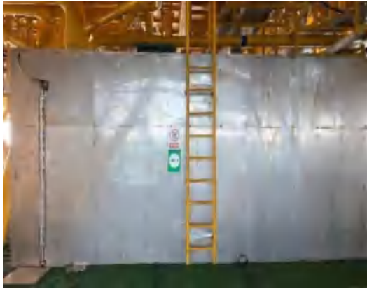
升压站事故油箱
