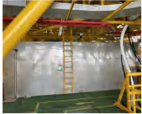
升压站事故油箱
